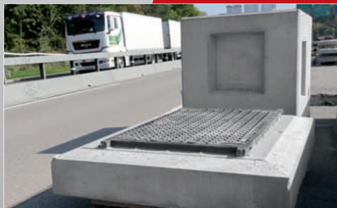
Pozzetto per cavi in cemento
