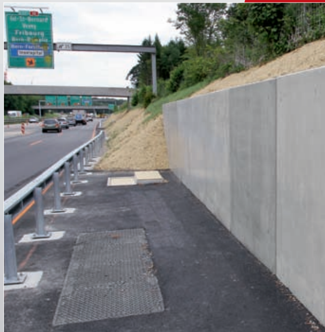
Niche avec puits de câble
