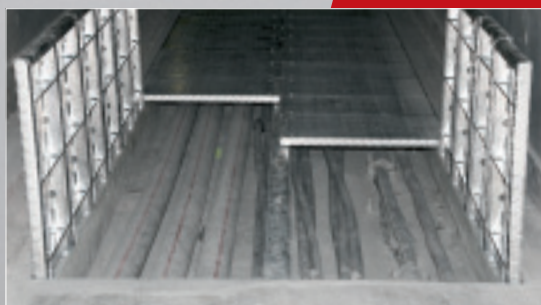
Chiusino parzialmente aperto
